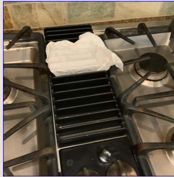
Exhaust fan operational.
